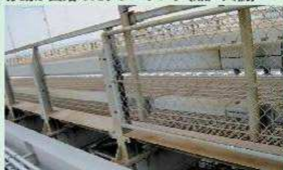
赤錆が出始めたグレーチング(瀬戸大橋)
