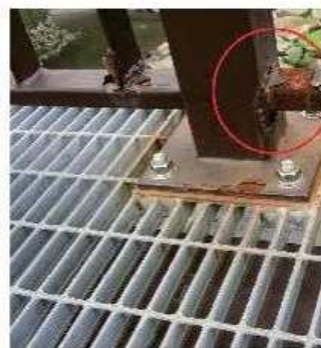
※○印 塗装品は塗膜剥離、赤錆が発生しています。
